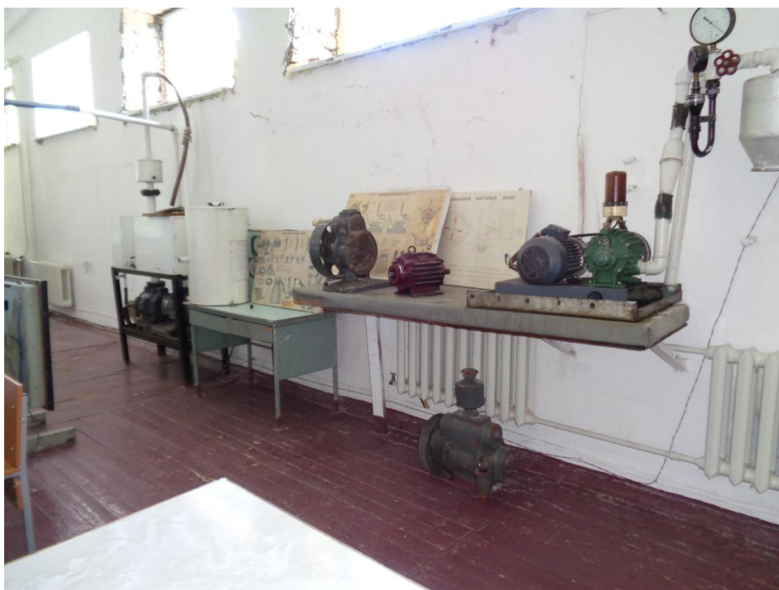
Водокольцевой вакуумный насос с баллонами
