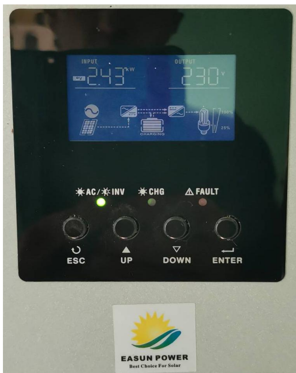
а – общий вид панели управления инвертором
