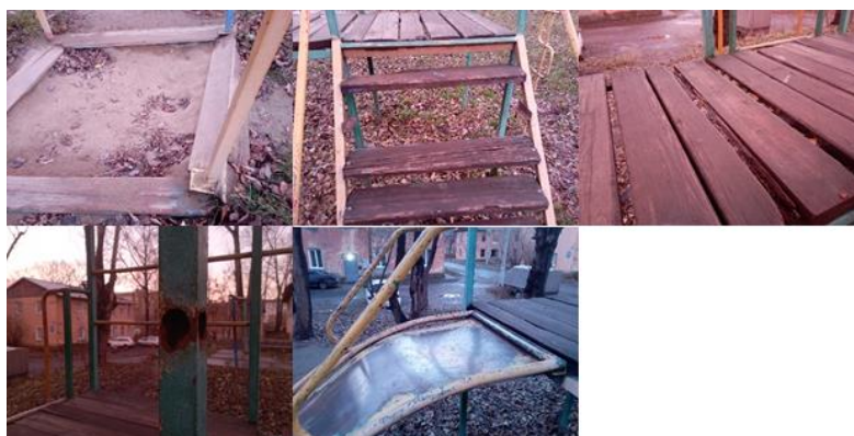
Рисунок 4 - Дефекты площадки на ул. Львовская
