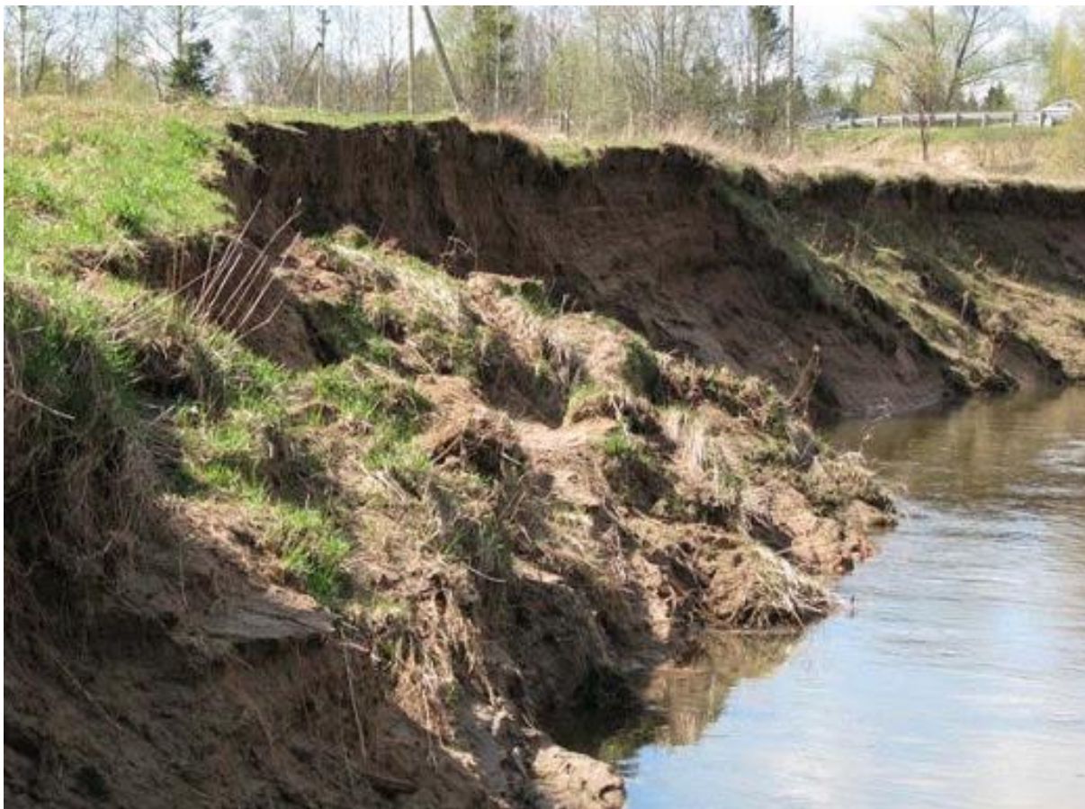
Рисунок 2 – Оползень при таянии снегов [8]
