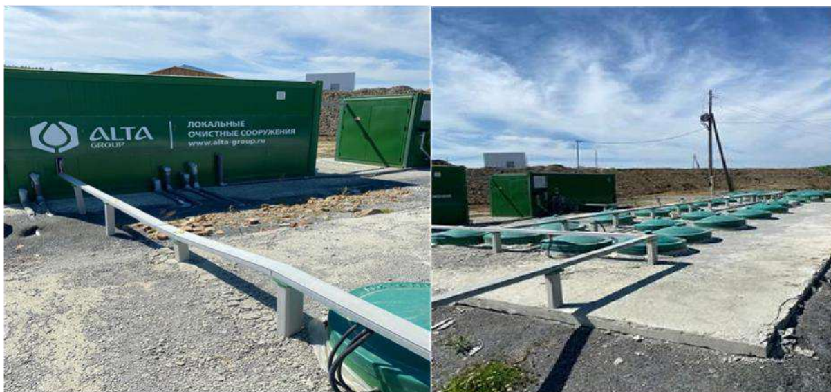
Рисунок 1 – Локальные очистные сооружения сточных вод
