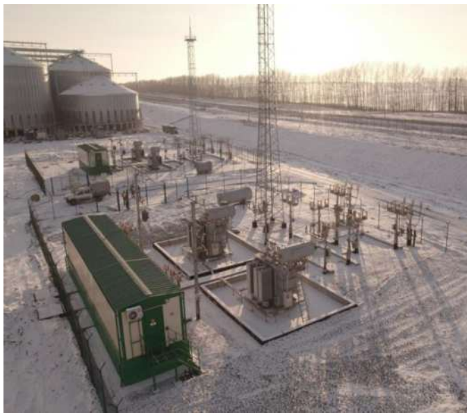
Рисунок 4- Электрическая подстанция «Баканская» 35 кВ
