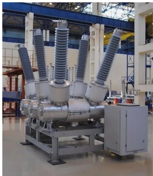
Рисунок 3 - Выключатель элегазовый ВЭБ-110-40-2500
